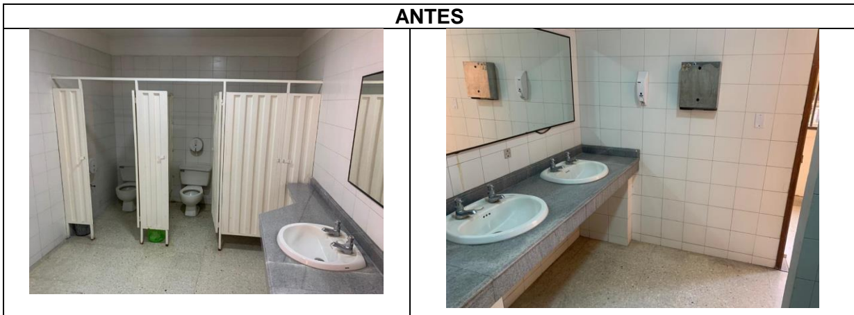
Fotografía 49 Adecuación y arreglo de los Baños públicos del primer piso de mujeres de la DTB
