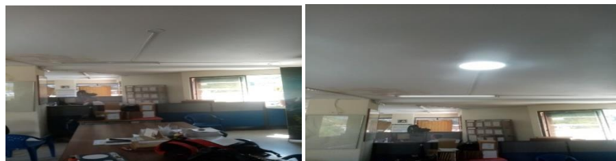
Instalación de canaleta y cable para la sala de conferencias en el quinto piso para poder dar uso VIDEO BEAM
