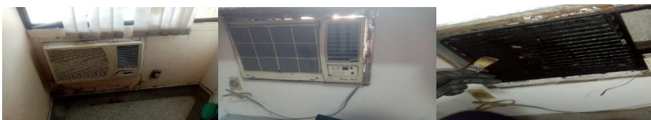
Mantenimiento de aire acondicionado asesor de contratación
