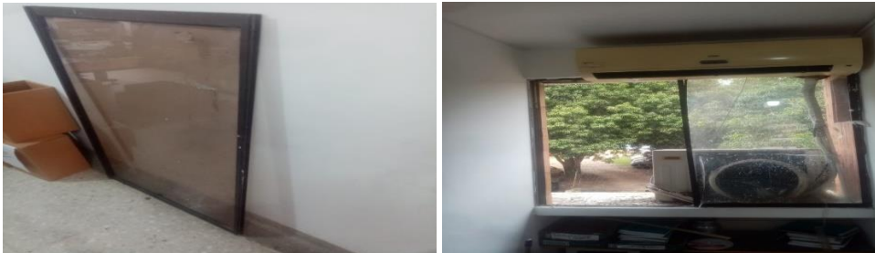
Se hace cambio de bombillo en la inspección séptima hace mediciones de corriente y se corrige una fase del aire acondicionado
