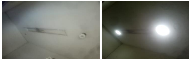
Se hace la instalación de 3 lámparas led para la oficina Control Interno Disciplinario
