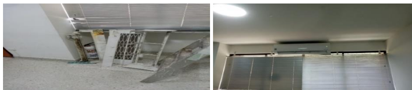
Mantenimiento de aire acondicionado este es la oficina Subtecnica
