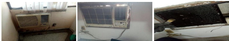
Mantenimiento de aire acondicionado asesor de contratación
